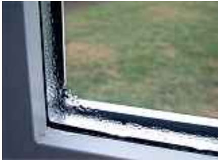
Kondensat im Randbereich der Innenseite
