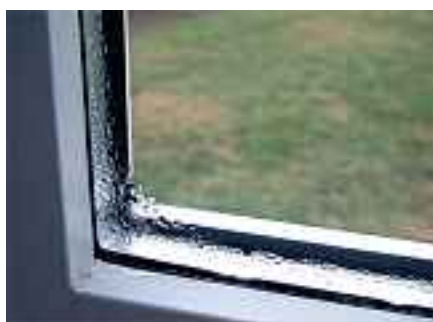
Condensation au niveau du bord de la face intérieure
