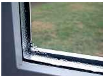
Condensa sui bordi del lato interno
